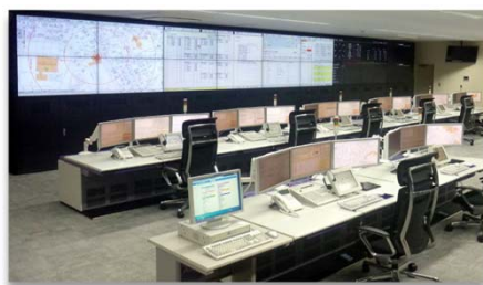
いばらき消防指令センターの内部
