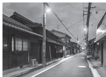
設置された LED 防犯灯照
