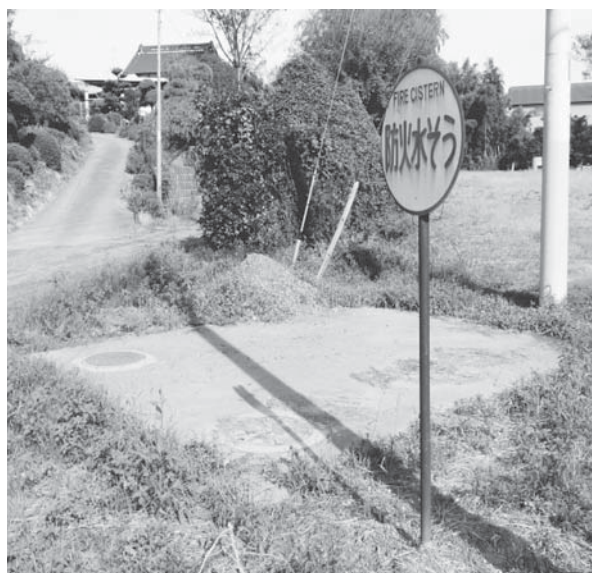
防火水槽 (鶴田地内)
