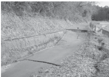
市内139カ所で道路の亀裂、陥没等の損壊が生じ、被災箇所の応急措置や道路上の障害物の除去作業が行われた (花野井川付近)
