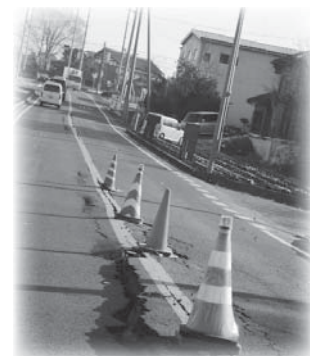
未曾有の東日本大震災により 市内随所で大きな被害 (23年3月11日)
