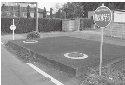
消火活動に欠かせない水の供給源として、市内各所に設置されている防火水槽や消火栓などの消火施設。設置・管理コストと活用時の妥当性に配慮した対応を求めたい
