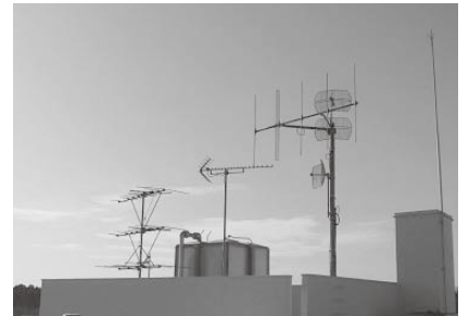
災害時等を含め市民への適切な情報提供を行う防災行政無線（屋上アンテナ）。現在も旧3町村時代からのシステムをそれぞれ運用。一本化にはデジタル化も含めた移行費用が大きな財政負担
